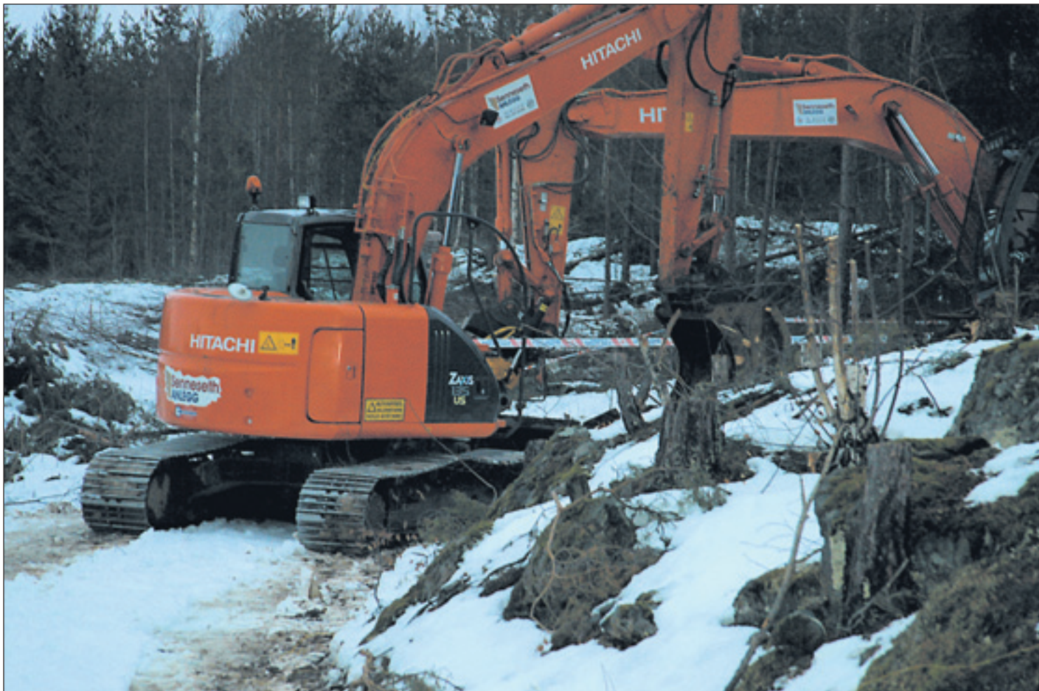
OVERKJØRT: Det var da to gravemaskiner møttes og den ene måtte rygge, at en mann ble overkjørt av den ene maskinen i Bergermarka.
