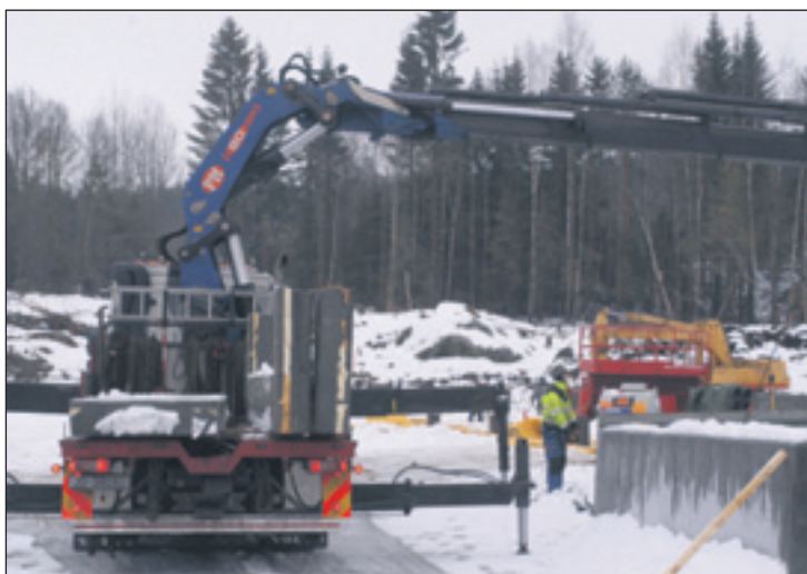
NYTT: De nye produksjons- og kontorlokaler til Alu Glass Produksjon AS kommer på dette området i Mohagen.
